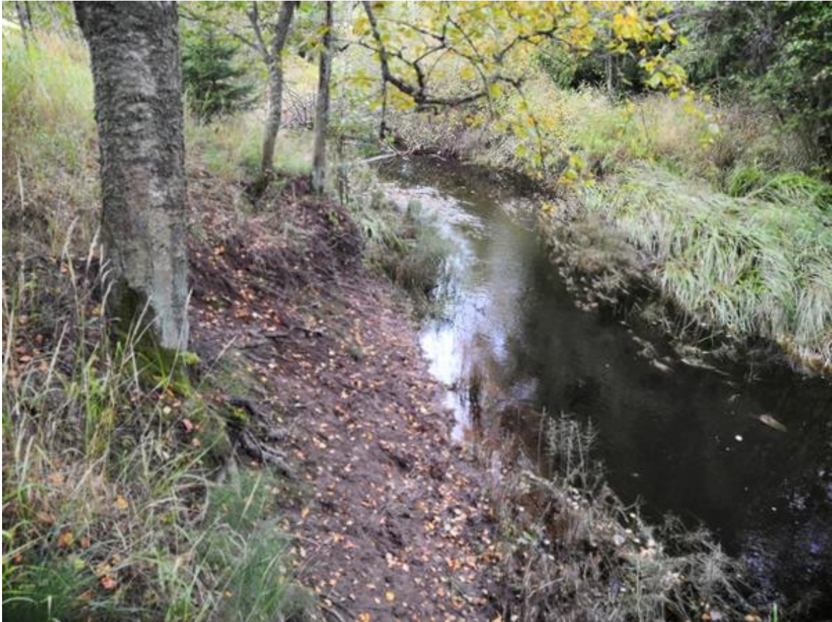
Erodoituvaa Mynäjoen pengertä Mynäjoentien sillan alapuolella.
